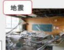
植草中学校の地震被害
